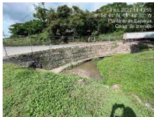
Un canal de aguas pluviales, que dependiendo del material podría contener ACM
