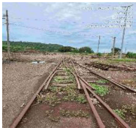
Vías de segmento de ferrocarril en desuso: presunto herbicida/suelo contaminado
