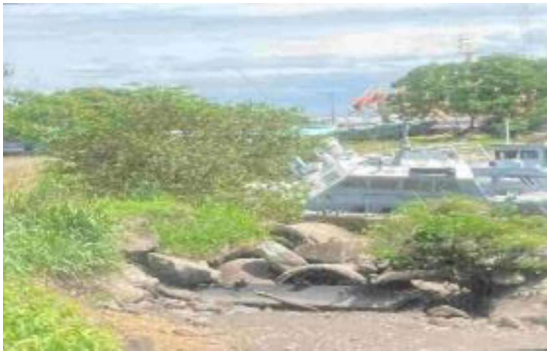
Supuesto ACM en el cemento de la tubería de aguas pluviales semienterrada (la tubería es de hormigón).
