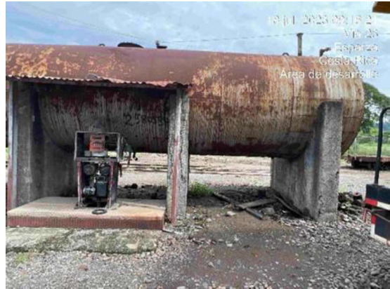
Suelo presuntamente contaminado por hidrocarburos cerca del AST
