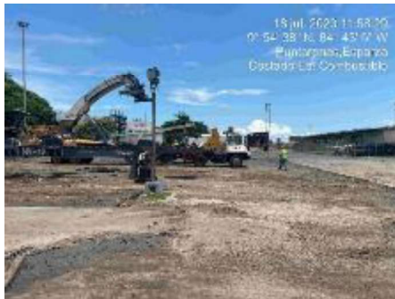
Suelo contaminado en la estación de combustible
