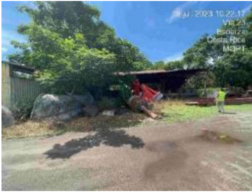
Almacenes y talleres abandonados considerados inseguros para ingresar debido a la presencia de suelo contaminado, charcos de líquidos, barriles y contenedores con contenido desconocido y mal olor.
