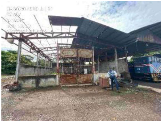
Entrada al taller mecánico abandonado, que contiene numerosos REC
