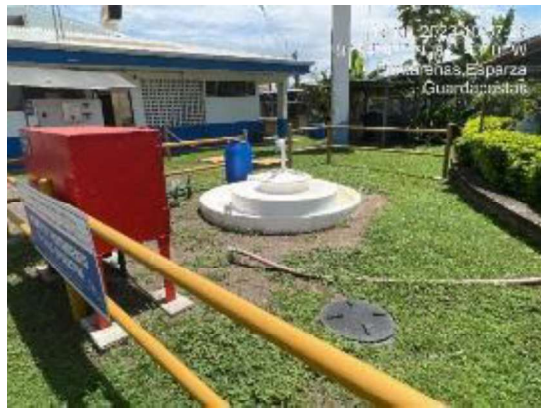
PTAR de Soda Operativa
