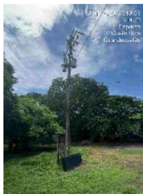
Un transformador montado en poste (Presunto contenido de PCB)
