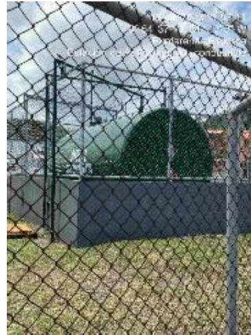
AST de diésel de aproximadamente 30.800 litros actualmente en uso
